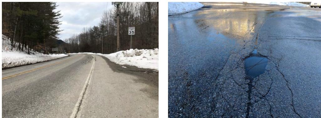
FIGURE 3.3 Fissuration de la chaussée due aux effets du gel et du dégel
