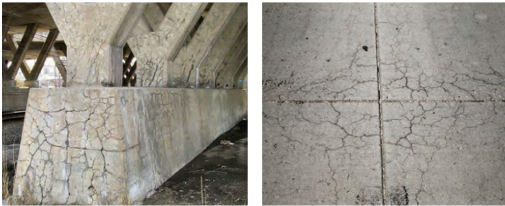
FIGURE 3.1 Fissuration du béton à la suite de la réaction Alkali-Agrégat (RAA)
