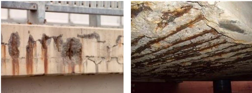
FIGURE 3.4 Éclatement du béton environnant dû à la corrosion des armatures en acier
