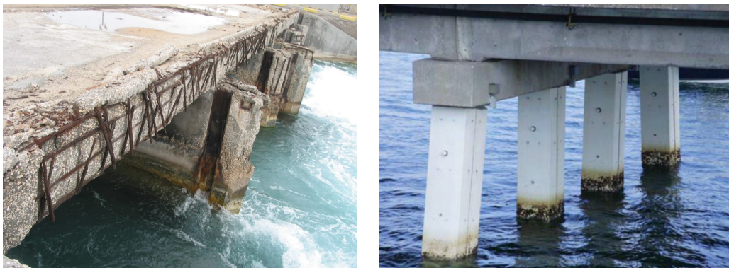
FIGURE 3.2 Les effets de l'attaque des chlorures, présents dans les sels de déneigement et dans l'eau de mer, sur le béton [51]
